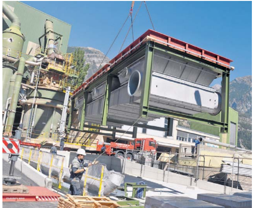
Millimeterarbeit. Mittels eines Spezialkrans werden die 30 Tonnen schweren Elemente auf dem Sockel platziert. FOTOS W
