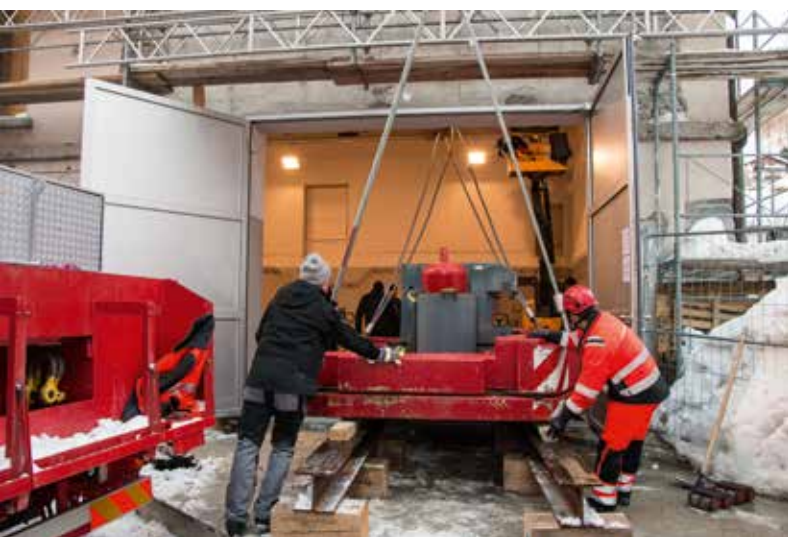
27,5 t Prüfgewicht für den Hallenkran.
